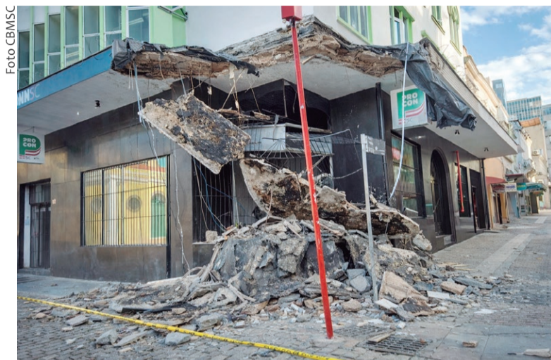
O DESABAMENTO de marquise no centro da Capital reforça a urgência de segurança estrutural de prédios públicos e privados
