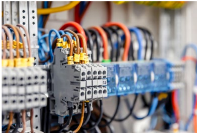
A INFRAESTRUTURA elétrica é, muitas vezes, relegada à manutenção pontual ou à intervenção apenas após um sinistro, causando uma série de prejuízos
