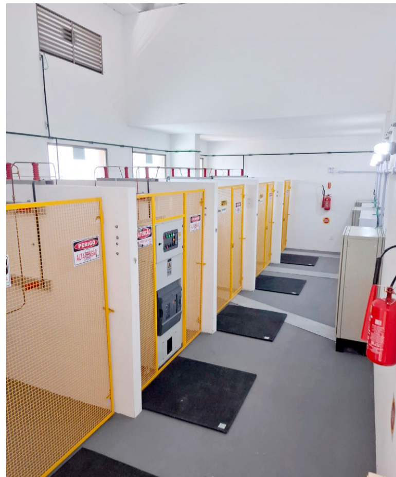
A SUBESTAÇÃO está entre os sistemas mais críticos da infraestrutura condominial e, por isso, exige acompanhamento constante
